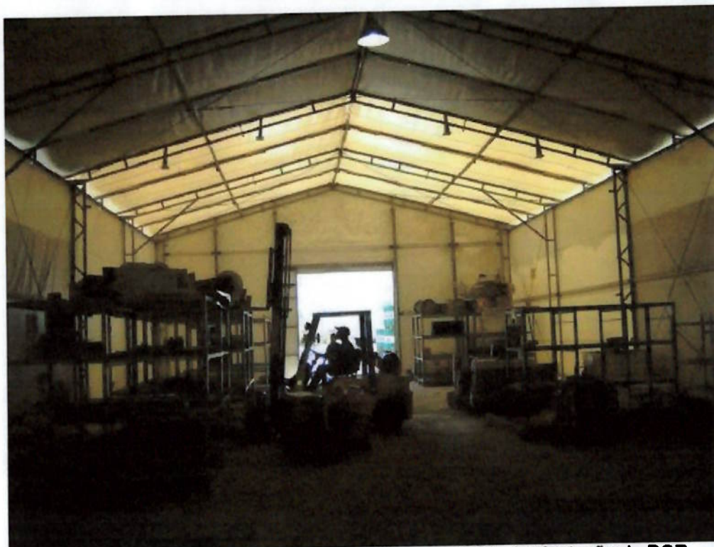
Foto 3.10 - Iluminação do galpão de resíduos, antes da implantação do PGR
