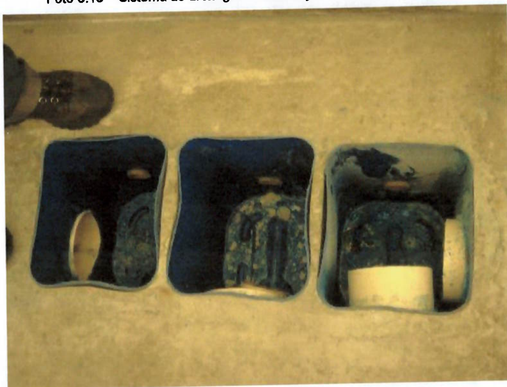
Foto 3.16 – Sistema de coleta da contenção dos produtos químicos
