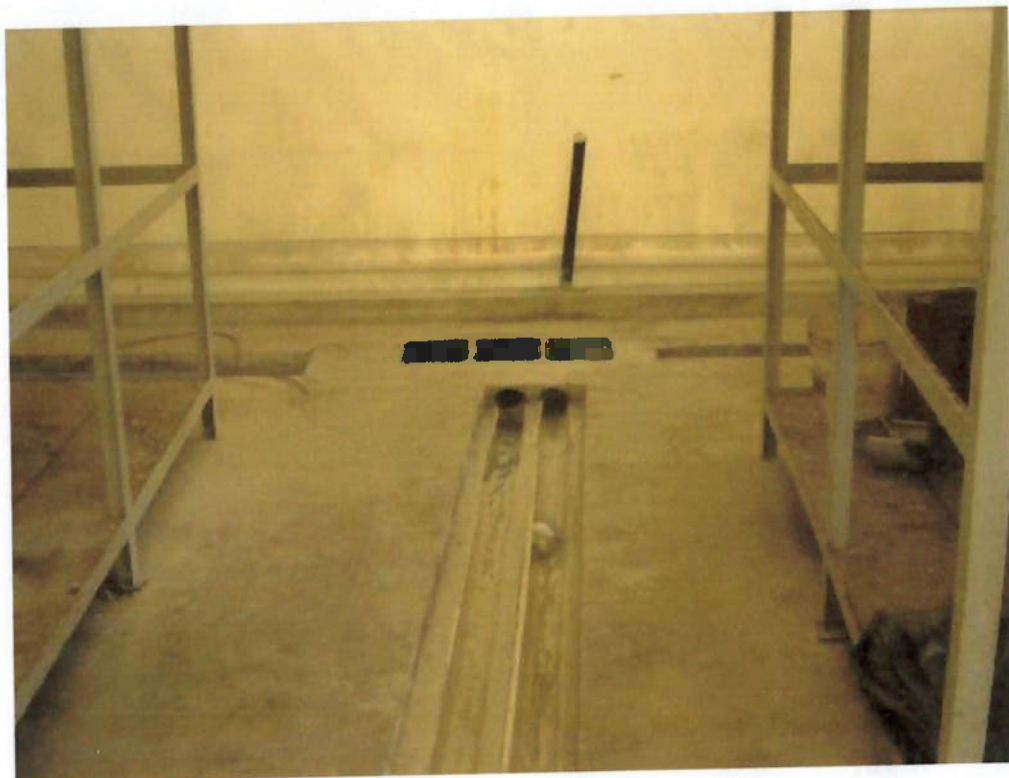
Foto 3.15 – Sistema de drenagem e contenção dos produtos químicos
