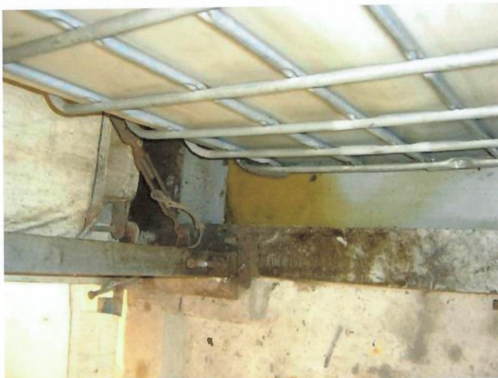
Foto 3.18 - Bacia de contenção de óleo antes da implantação do PGR com sinais de vazamento.
