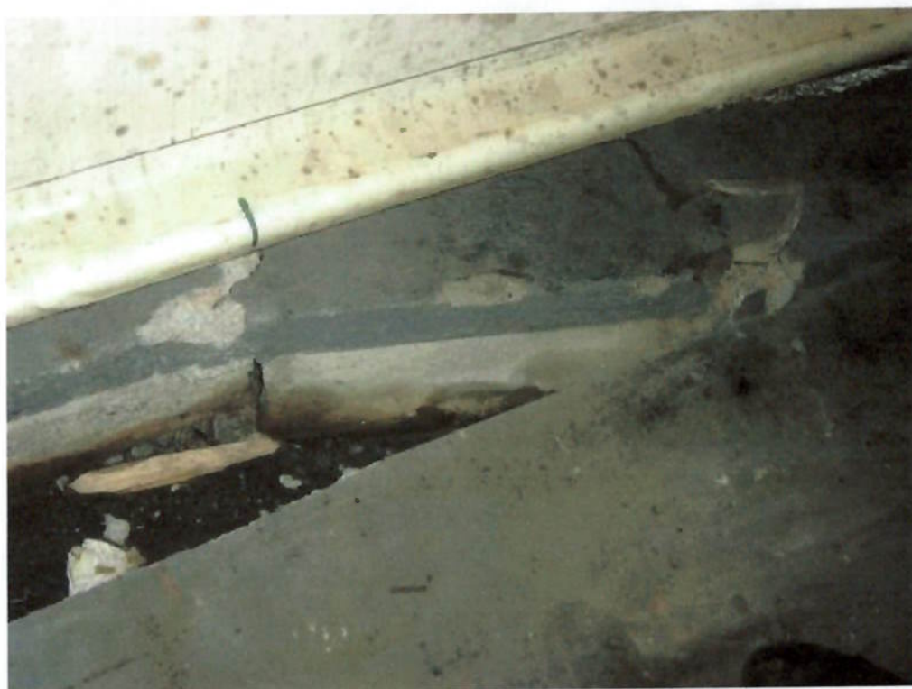
Foto 3.19 – Contenção que percorre todo o perímetro do galpão, com sinais de avarias.
